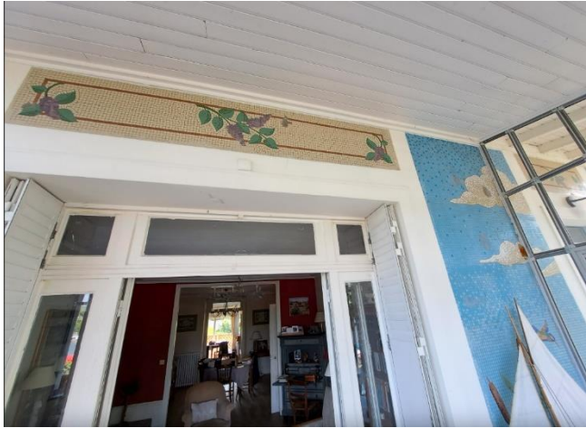
Figure 6 Vue fournie par le propriétaire qui montre d'intéressantes mosaïques autrefois en façade avant la construction de la véranda.
